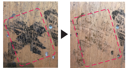
壁に付着したゴム跡 ※赤枠Gクリーナーを塗布
